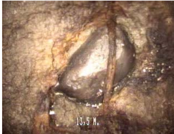
Figure 67 – (Photo 7) Éclat de surface avec armature visible
