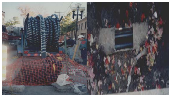
Figure 51 – Exemple de tubage déformé
