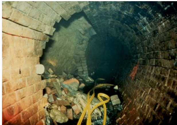
Figure 28 – Illustration d'un vide important dans le cas d'une conduite en brique
