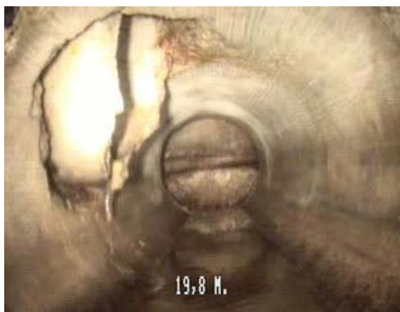
Figure 72 – (Photo 4) Raccordement pénétrant et défectueux
