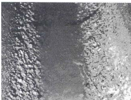
Figure 26 – Exemple d'abrasion du radier d'une conduite (Source Stein, D., 2001)
