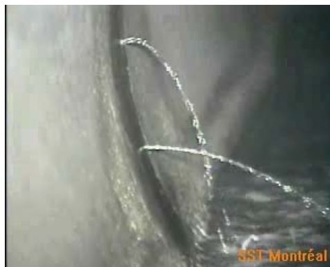
Figure 3 – Exemple d'une infiltration à travers un joint non étanche
