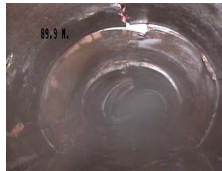
Figure 21 – Exemple d'une conduite déformée
