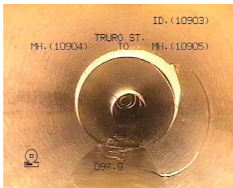
Figure 13 – Exemple d'une fissure circulaire
