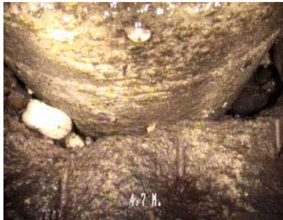
Figure 64 – (Photo 4) Raccordement à la masse défectueux et pénétrant - Armature apparente
