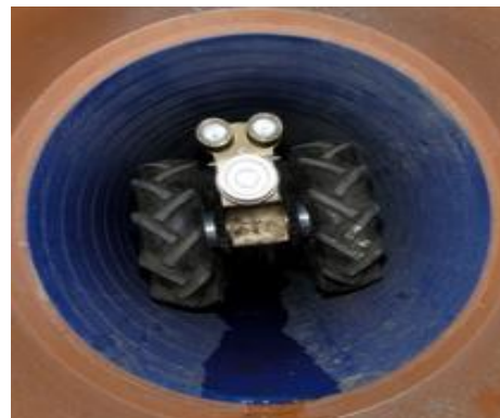
Figure 41 – Caméra d'inspection à l'intérieur d'une conduite (Gracieuseté de Cues)
