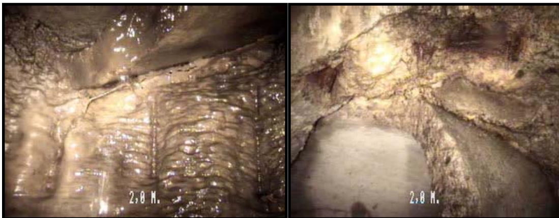
Figure 62 – (Photo 2) - Raccordement à la masse défectueux et pénétrant / Dépôts attachés - incrustation / Armature visible / Suintement
