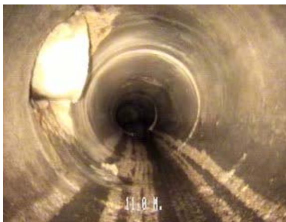
Figure 66 – (Photo 6) - Raccordement pénétrant avec armature visible sous le radier
