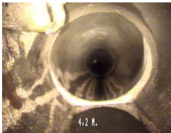
Figure 65 – (Photo 5) Joint décalé moyen
