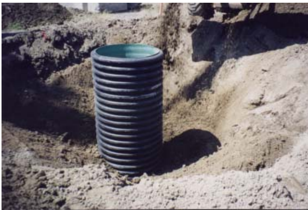
Figure 3.19 - Essai 1.2.B : Mise à l'essai du PEHD-36 dans la tranchée B Ville de Longueuil
