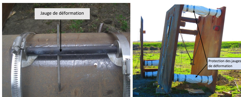
Figure 20. Jauges de déformation installées sur les membrures des boîtes de tranchée.
