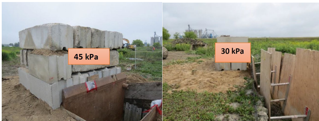
Figure 37. Pression exercée sur le sommet de l'excavation par la surcharge, tranchée B (gauche) et tranchée C (droite).
